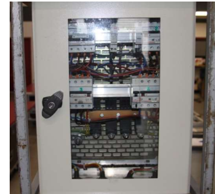
Armoire électrique 125A – 4x32A
